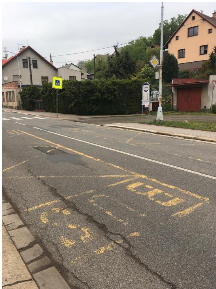
Obrázek 66 Mizející vodorovné dopravní značení zastávky "Lomnice nad Popelkou, rozc. k žel.st."
