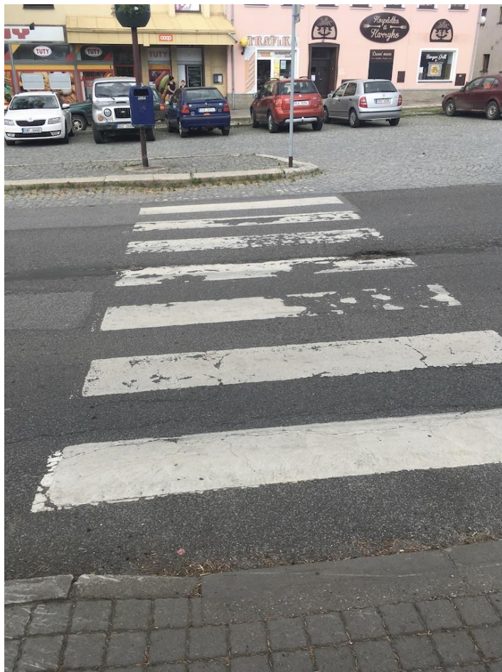
Obrázek 109 Opatřebované vodorovné značení přechodu pro chodce před komunikací č. 290
