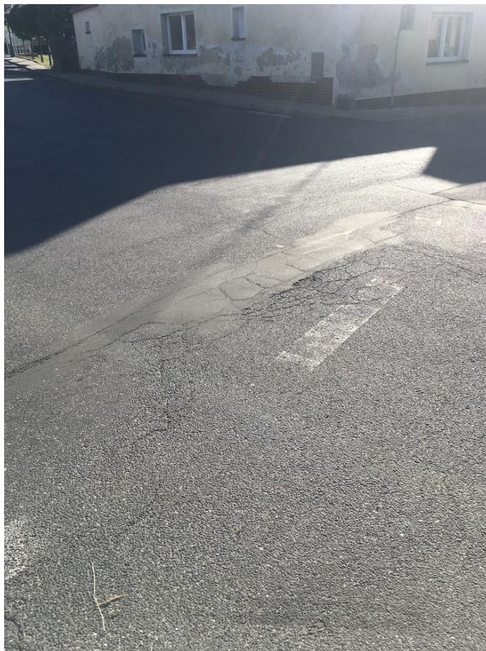
Obrázek 115 Opatřebované vodorovné značení
